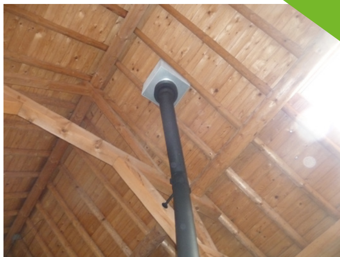
Goed aangelegd rookgaskanaal
