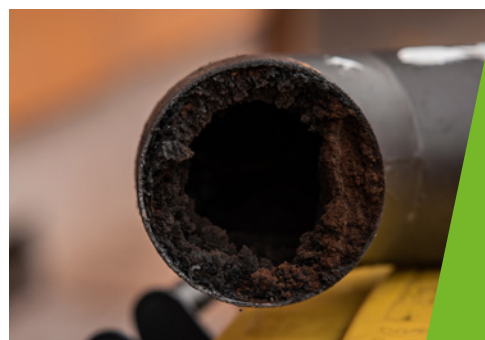
Aanslag aan de binnenkant van het rookkanaal
